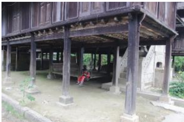
Gambar 10. Pondasi umpak yang terbuat dari semen berbentuk geometris, tiang kayu berbentuk segi empat dan sambungan tiang dengan balok lantai Rumah Limas dengan panggung tinggi. Lokasi Naumbai, Koto Air Tiris
