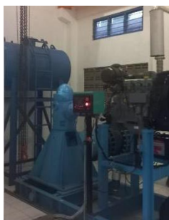
Gambar 2. Dokumentasi rumah pompa banjir dan indikator ketinggian air
